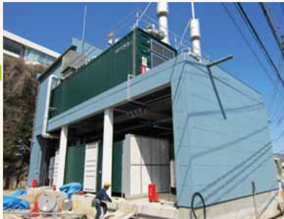
プラント外観
